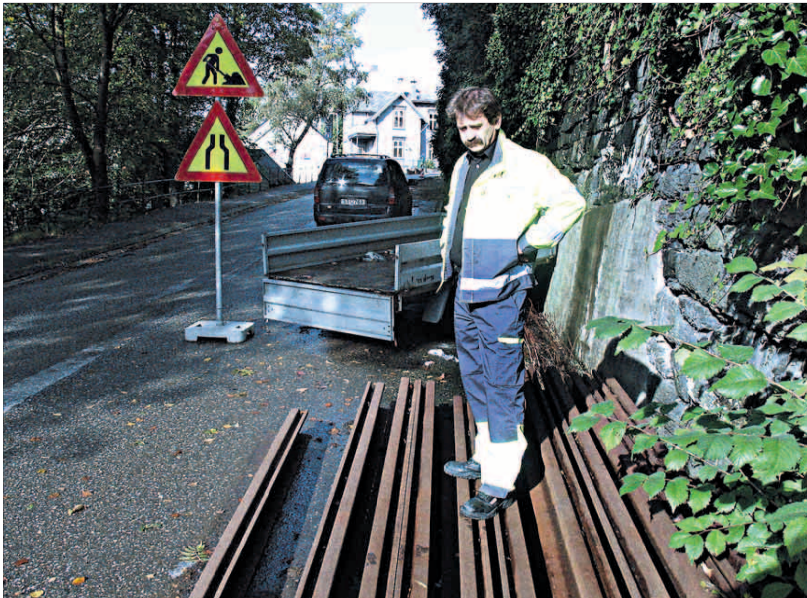
TRØNDESKINNER: Atle Ingebrigtsen og de andre trikkeentusiastene skal nå begynne arbeidet med å legge de gamle skinnene i Olaf Ryes vei.
